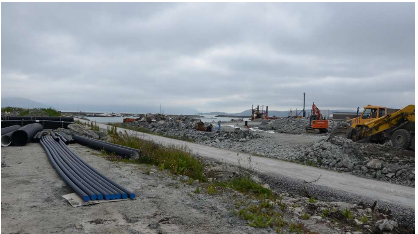
På Brekstad jobbes det stadig med pælearbeid og utfylling. FOTO: AUDUN FEGRAN KOPPERUD
