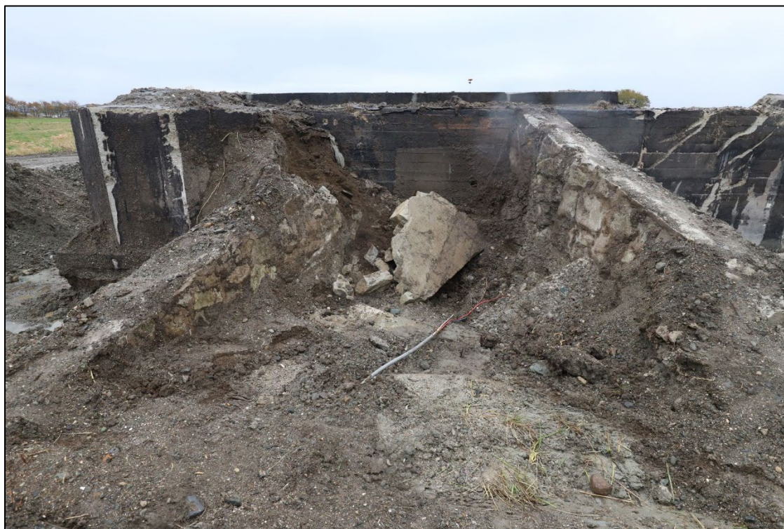
Figur 5 Anlegg 1 sett mot Ø. Splintvern ved gjenstøpt inngang i V-siden. Foto: Jørn Iver Nikolaysen © 2024
